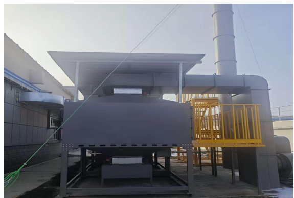
废气处理设施
